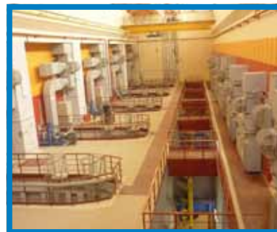
CH Grodnenskaya Interior de la Casa Máquinas
